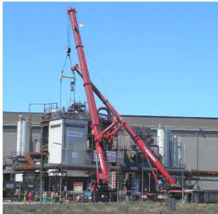
شکل 9 : واحد پایلوت در حال شارژ
